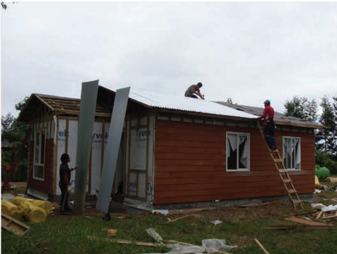
Terminada la estructura de cubierta se realiza instalación de barrera de humedad y revestimiento de cubierta. Paralelamente se pueden ejecutar instalación de ventanas, puertas, revestimiento interior y exterior.
