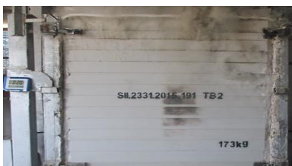
Figura N° 17 FALLA POR AISLAMIENTO TÉRMICO (41x90 mm)
