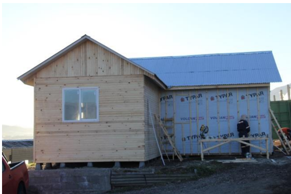
Figura N° 22 INSTALACIÓN SEPARADORES VERTICALES
