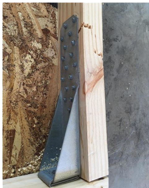
Figura N° 12 FALLA DEL PIE DERECHO EN TRACCIÓN
