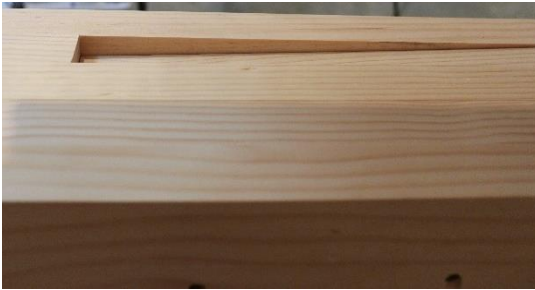
Figura N° 19 FALLA TÍPICA EN FLEXIÓN LAMINACIÓN VERTICAL CON EMPALME
