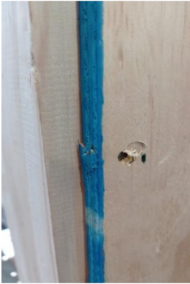
Figura N° 24 FALLA POR APLASTAMIENTO LOCAL DEL TABLERO CONTRACHAPADO
