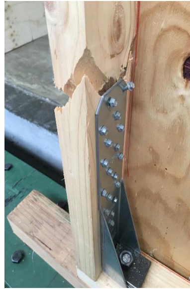
Figura N° 25 FALLA PIE DERECHO TRACCIONADO EN ZONA DE UNIÓN CON HERRAJE
