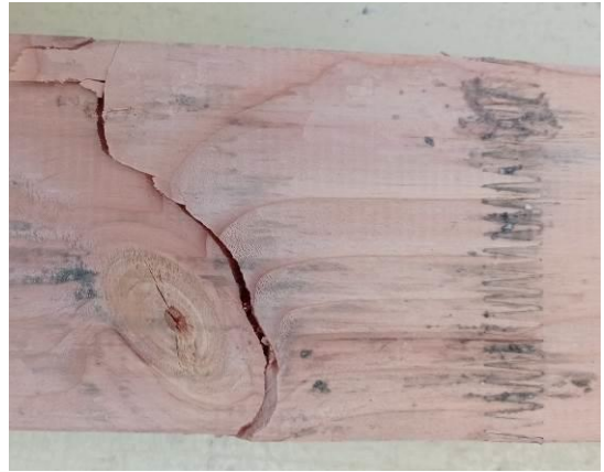
Figura N° 14 FALLA EN ZONA NUDOSA
