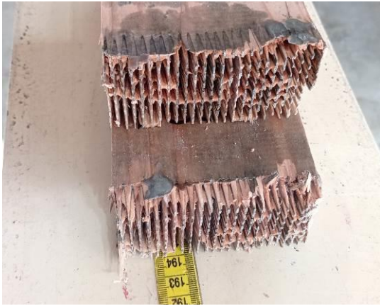
Figura N° 13 FALLA POCO COMÚN EN PAREDES DEL DIENTE
