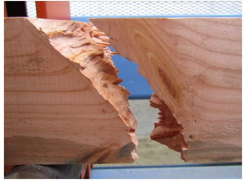
Figura N° 18 FALLA EN ZONA NUDOSA
