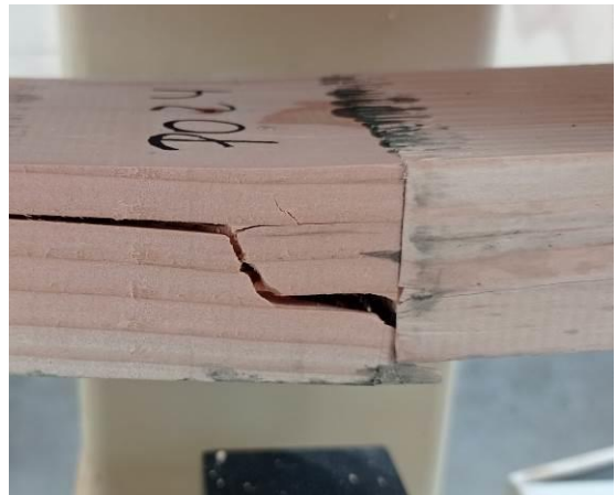
Figura N° 12 FALLA TÍPICA EN ZONA FLEXO-TRACCIONADA
