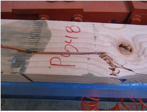
Figura N° 17 FALLA EN ZONA NUDOSA
