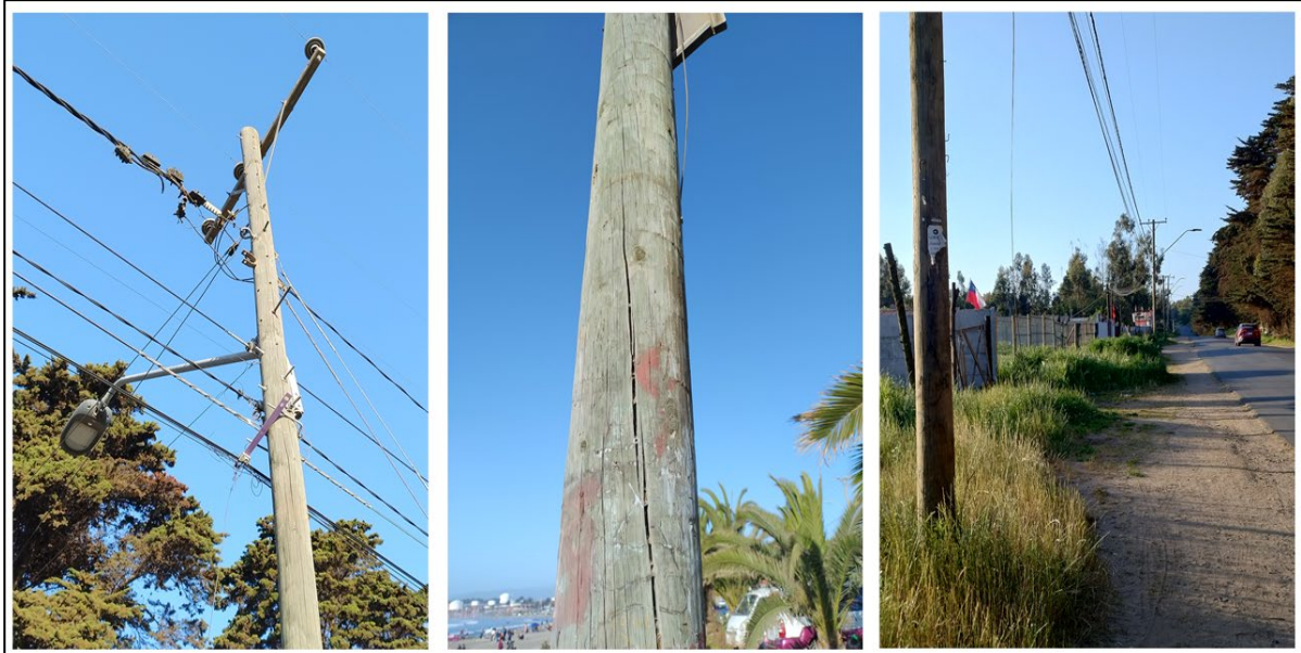
Figura 5. Postes de madera para el tendido eléctrico, ubicados en camino Horcón-Ruta f-30. fotografía sector caleta Horcón, comuna de Puchuncaví, Región de Valparaíso. Octubre 2023.
