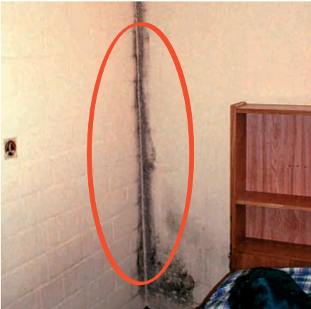
Humedad por condensación
