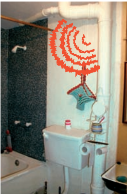
Ruido por descarga de artefactos sanitarios
