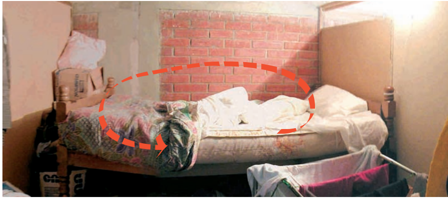
Dormitorio sin ventilación
