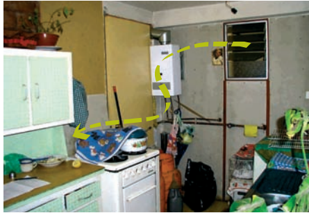
Baño ventilando a cocina por eliminación de loggia
