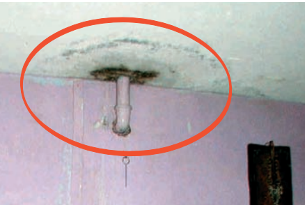
Humedad por problemas en cañerías
