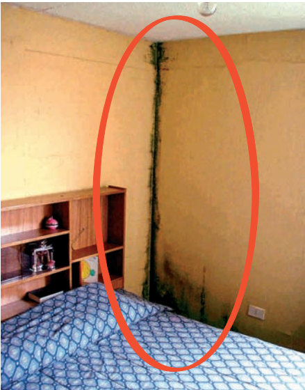
Humedad en dormitorio
