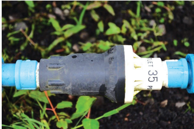
Figura 6 REGULADOR DE PRESIÓN INSTALADO EN SECTOR DE RIEGO PARA MANTENER CONSTANTE LA PRESIÓN EN LAS LÍNEAS DE RIEGO Y ASPERSORES
