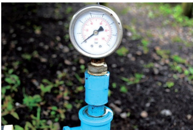
Figura 5 MANÓMETRO INSTALADO EN LÍNEA DE RIEGO PARA EL MONITOREO DE LA PRESIÓN DE LOS ASPERSORES
