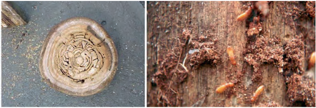
Figura N° 8 DAÑO CAUSADO POR TERMITAS, ADULTOS EN GALERIAS
