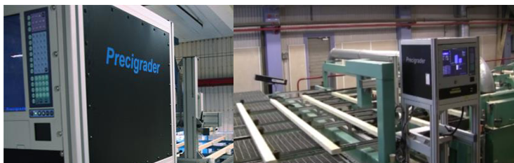
Figura N° 10 PRECIGRADER MODELO PG100/PG180 INSTALADO EN ASERRADERO
