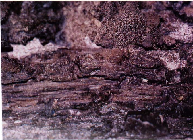
Figura 6: Daño en madera producido por termitas. Obsérvese el aserrín compacto.
