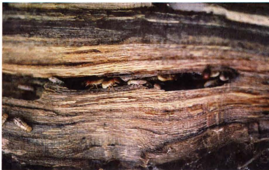
Figura 7 : Galería en la madera con termitas aéreas.
