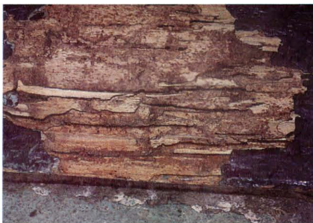
Figura 11 : Daño en la madera producido por termitas subterráneas
