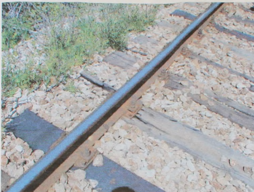
Foto 7. El primer durmiente (abajo) corresponde a uno nuevo impregnado. Junto a este se encuentran una serie de durmientes sin impregnación en mal estado (teniendo pudrición y/o tirafondos sueltos). Este es un punto de debilidad de una vía clase E, debido a que la norma no permite 2 durmientes consecutivos en mal estado. También se aprecia pasto y la falta de hombro en la distribución del balasto, no obstante que la vista fue extraída de una recta de gran longitud.
