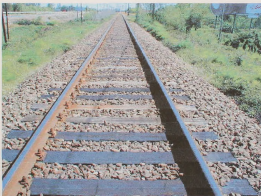
Foto 14. Vista general de la vía en el kilómetro 379. Esta zona pierde el estándar de vía debido a la cantidad de durmientes sin impregnación que se encuentran agrupados y que eventualmente están afectados por biodeterioro, tirafondos y/o sujeciones sueltas.
