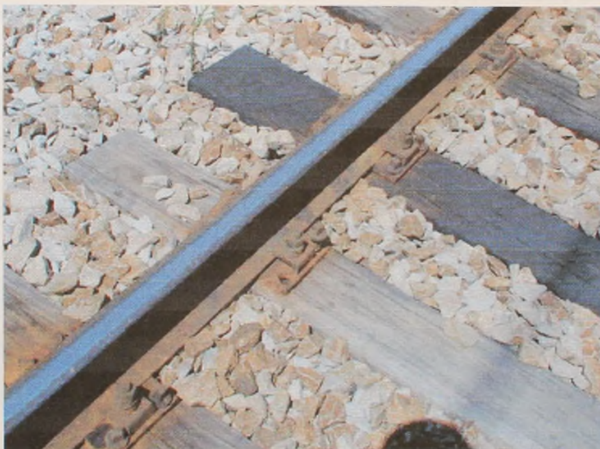
Foto 6. La fotografía muestra la ausencia de un tirafondo en la silla de asiento de un durmiente sin impregnación. El tirafondo adyacente se está levantando debido a vibraciones ocasionadas por el paso de los trenes.
