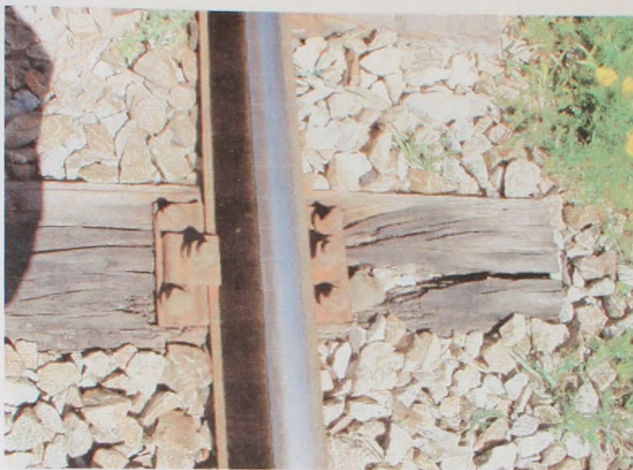
Foto 3. En este durmiente de la zona de Molina se aprecia una importante pudrición bajo la silla de asiento y en la cabeza del durmiente. Por lo general, en los durmientes que presentan pudrición los tirafondos no están cumpliendo su función de anclaje. Se observa, además, que la vegetación comienza a crecer entre el balasto.
