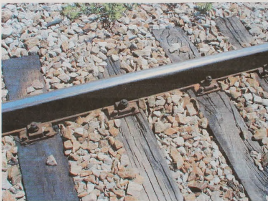
Foto 8. Los dos durmientes centrales presentan pudrición. Se observa la presencia de pasto junto a los durmientes.
