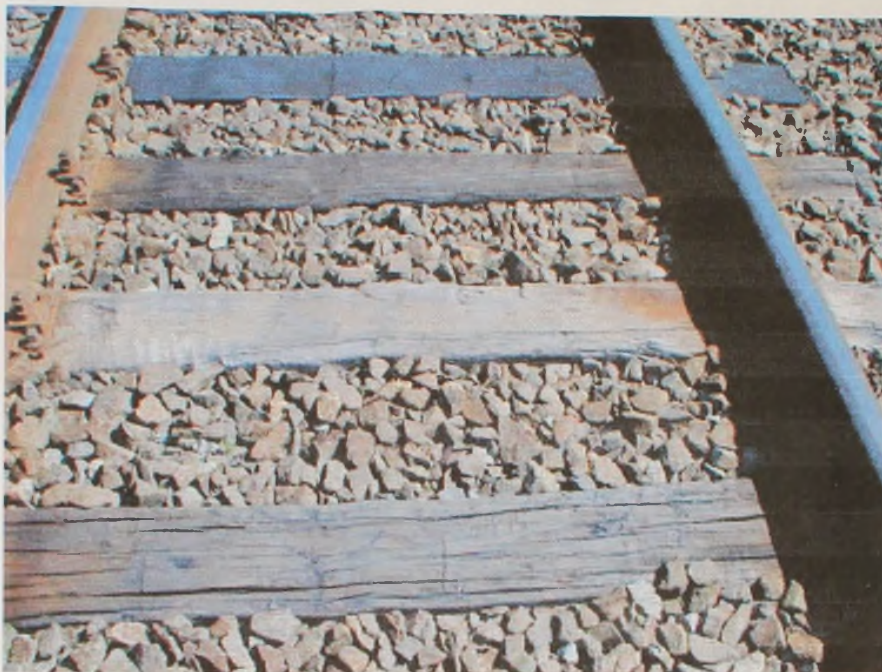
Foto 13. El primer durmiente (abajo) es uno del tipo no impregnado, incluso con marca del año 95. Junto a él se aprecian durmientes del tipo no impregnado, impregnado antiguo e impregnado nuevo.
