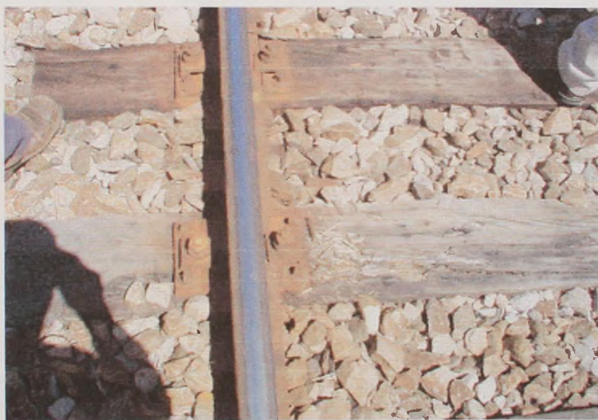
Foto 2. En la foto capturada en la misma zona se aprecia pudrición en un durmiende sin impregnación. En la unidad siguiente, correspondiente a un durmiende impregnado antiguo, no presenta deterioro.
